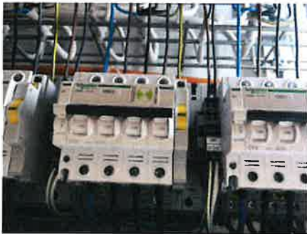
Marquage sur le disjoncteur
