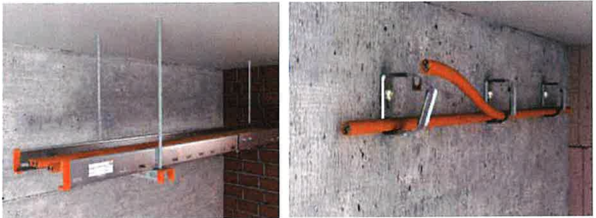
Exemples de chemin de câbles avec maintien de fonction (OBO Bettermann AG)
